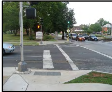
傾斜路が横断に沿っていない
